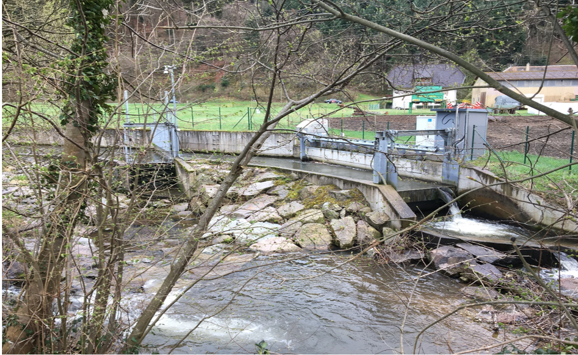
Fischaufstieg als raue Rampe und Fischabstieg einer kleinen Wasserkraft am Neumagen in Baden-Württemberg
